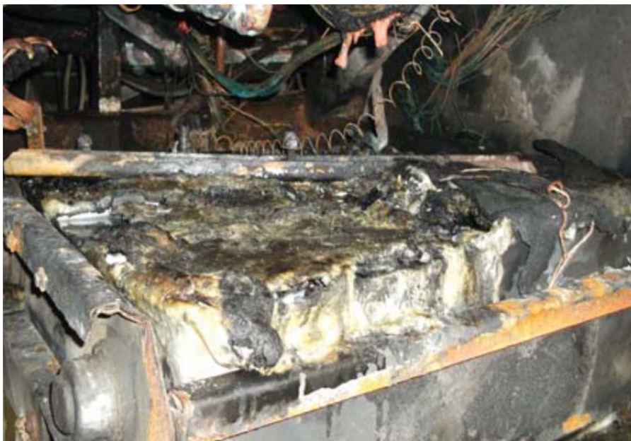
Kuva. Palossa tuhoutunut akkulaatikko
