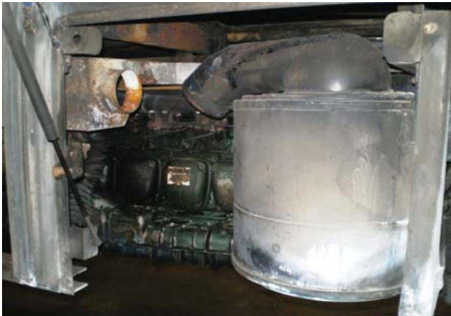
Kuva. Moottoritilan vaurioita
