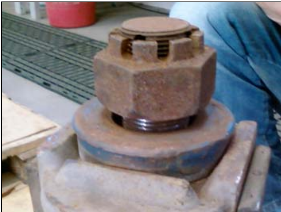
Kuva 18: Asennuksen yhteydessä rasvaamaton päätymutteri
