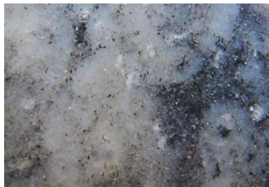
Nastan jälkiä kivilevyn pinnalla
