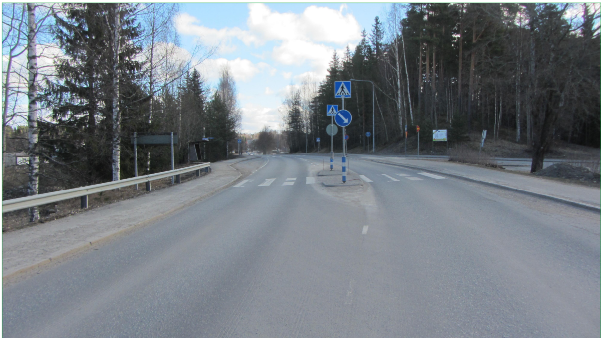
Kuva 23. Mt292, Turengintie, Lukiotien liittymä – kuva ennen toimenpiteiden toteuttamista (toimenpiteet nro 10).
