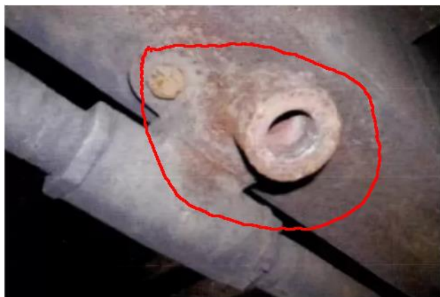
Обрыв подводящей трубки
