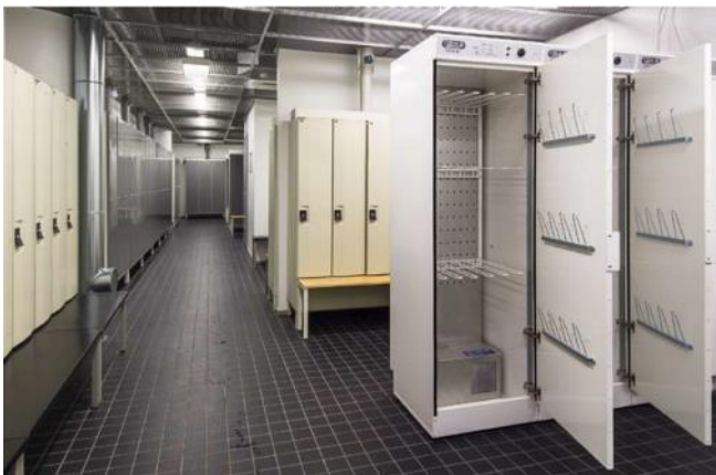
Kuva ja lähde: Pukuhuoneeseen sijoitetut kuivauskaapit työmatkaliikkujien vaatteita varten. (RT 103140 Henkilöstötilat)
